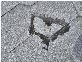
Tekking (med tilhørende beslag) - Skade som er utbedret
