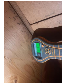
Synlige overflater (taktro, vegger, gulv, o.l) - Fuktmåling i taksperre.
