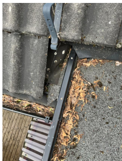
Mangelfull overgang mellom saltak og pulttak
