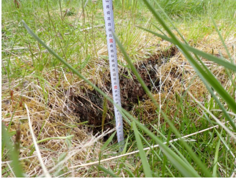
Hull/sig ved kulvert
