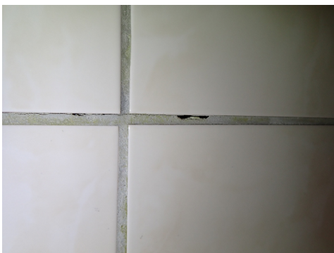
Eksempel på oppsprekking og småskader i fuger
