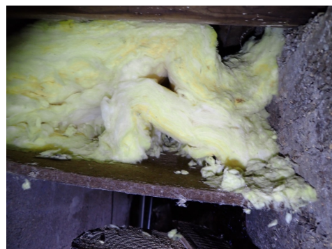
Asfaltplater er nedbøyd, spor etter smågnagere (bol)
