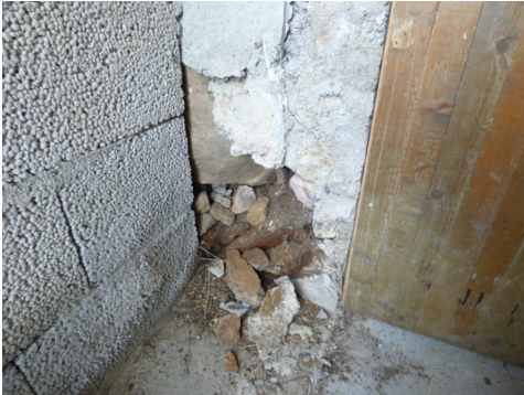
Skade ved dør til kjeller
