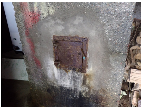
Noe rust på sotluke
