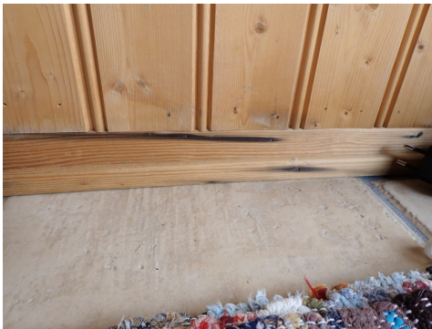
Rust/fuktmerker på gulvlist
