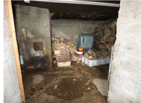
Deler av betongdekke er borte
