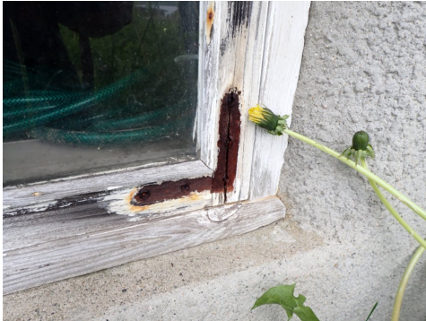
Utvendig beslag er borte
