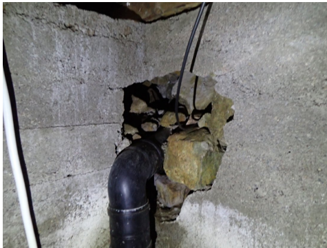
Hull i vegg, trolig tatt ifm avløpsrør
