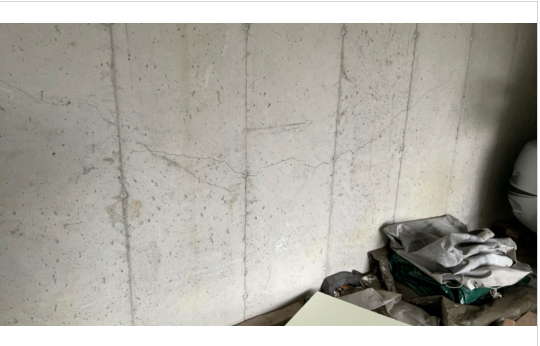
Det er sprekker i grunnmur.
