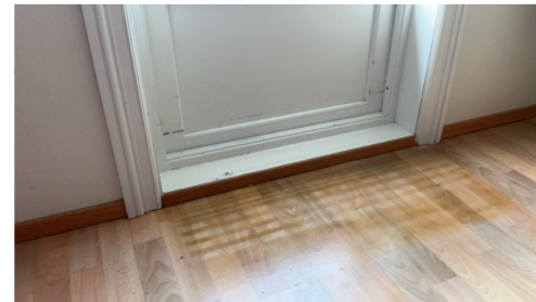
Skade på belegg.
