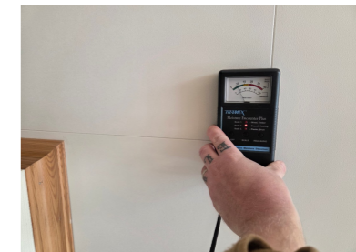
Fuktsøk i tak stue.
