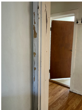
Slitasje på karmen, gerikter, foringer, terskler og dørblad
