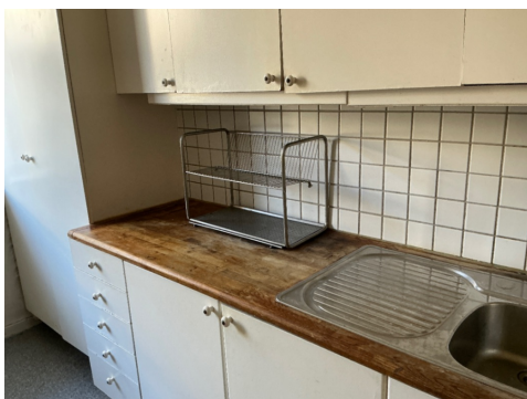
Slitasje på benkeplate og innredning
