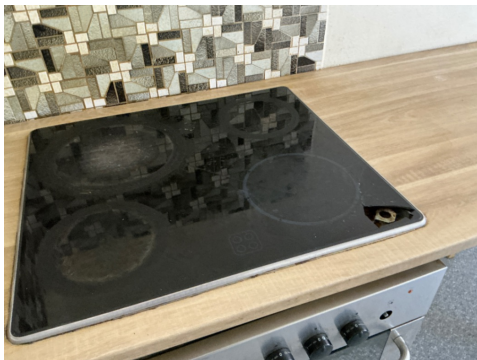
Skade på platetopp
