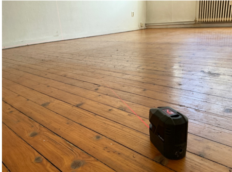
Nivellering stue, avvik ca. 10-20 mm
