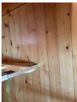
Skjevhet på 5 cm på innvendige gulvoverflater
