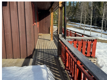
Skjevheter i terrasse
