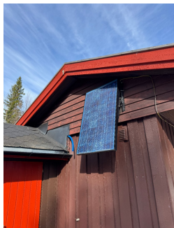
Solcellepanel montert på yttervegg
