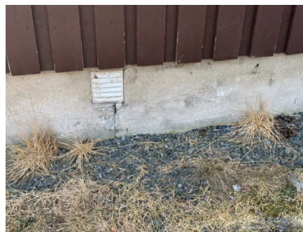
Sprekker i grunnmur
