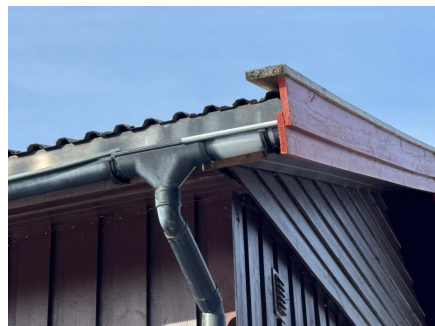
Slitasje og skade i overflater av takrenner
