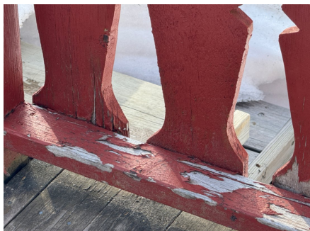
Slitte overflater på terrasse
