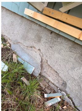
Avskalling av grunnmur utvendig.
