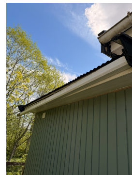
Eldre treakrenne, denne bør fjernes, og ny takrenne med tilhørende beslag og nedløp bør etableres.
