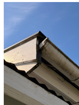
Takrenner har tegn til uttetheter i endelokk og i renneskjøter.
