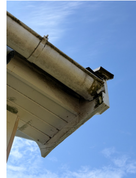
Vindskier fremstår med spredte råteskader.
