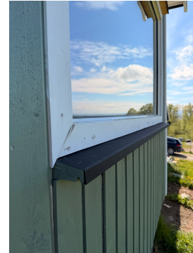
Vindusdetaljer fremstår med ufagmessig utførelse.
