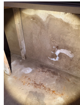
Tegn på fukt gjennomtrengning.
