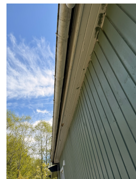
Gesims har malingsblommer, og stedvis fuktpåvirkning.
