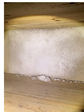
Det er registrert saltutslag (effloresens) flere steder i kjelleren.
