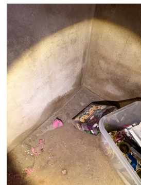
Det er fuktige overflater langs yttervegg.
