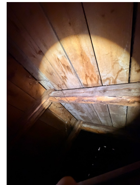
Fuktskjolder på undertak, tørre verdier på befaringsstidspunktet.
