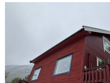
Mangler taknedløp på takrenne øst
