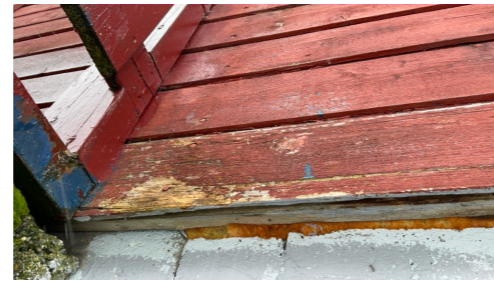
Stedvis avslitt maling, enkelte råteskadde bord
