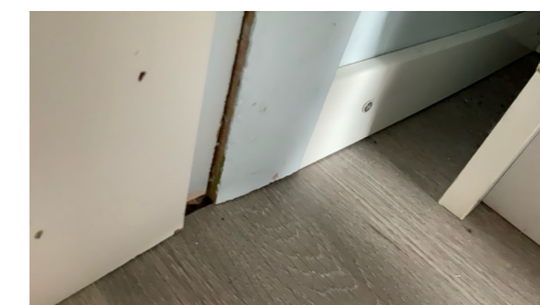
Ikke fagmessig utført
