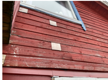
Værslitt, metallbeslag over skjøter
