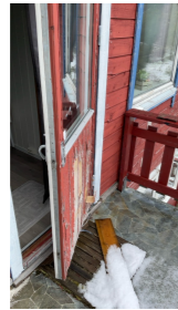
Fukt/råteskadd altandør loft, mangler også vridere ytre del
