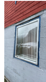
Eldre vindu kjeller, ikke montert beslag underkant.
