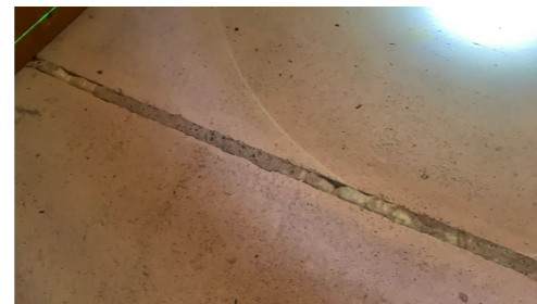
Sprekk i gulv kjellerbod
