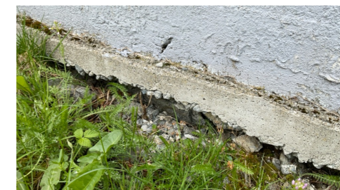
Manglende kontakt mellom mur/fundament og underlag
