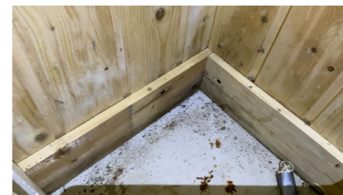
Fuktskade trepanel, målt forhøya fuktverdier.
