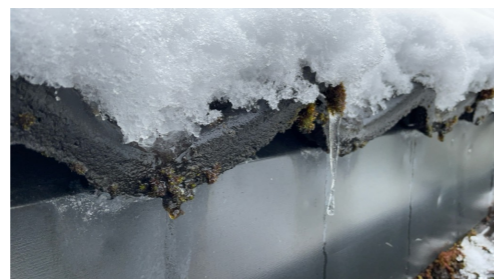
Mose, åpent mellom beslag og takstein
