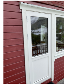
Altandør sør mangler beslag over/under dør
