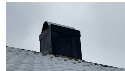
Tegn til korrosjon, pipeledning
