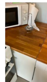
Ikke fagmessig utført overgang og løsning i hjørne
