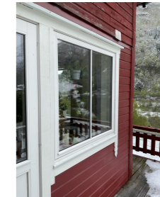
Vindu uten beslag i underkant
