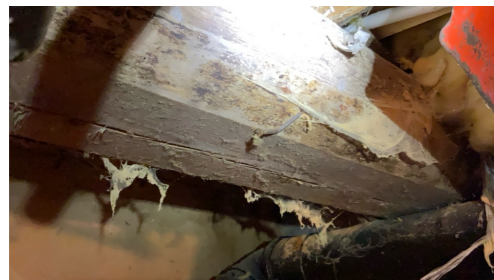
Hull etter borebille/mott i bjelkelag
