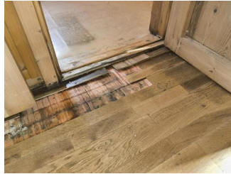
Overflater gulv - Synlige fuktskader på utsiden av bad
