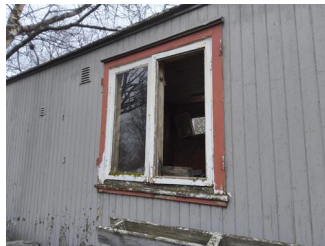
Vinduer, dører og porter - Defekt vindu
