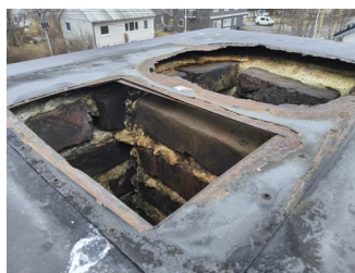
Skorsteiner (over tak) - Rust i takhatt
