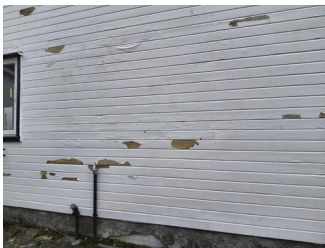
Overflatebehandling - Slitt og skadet overflatebehandling
