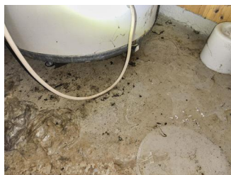
Varmtvannsbereder - Synlig lekkasje fra varmtvannsbereder
