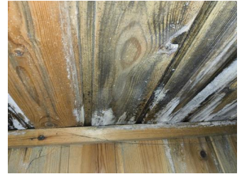
Overflater gulv - Fuktmærker og muggsopp i himling under bad
