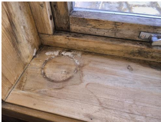
Ventilasjon - Fuktmærker etter kondens i vindu
