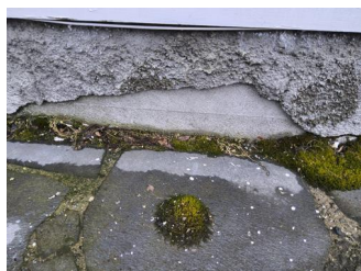
Grunnmur og fundament - Avskalling av murpus
