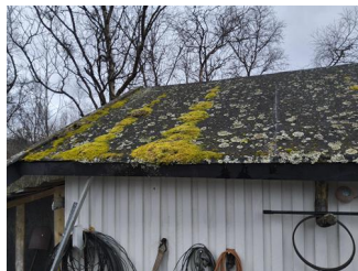
Yttertak og takkonstruksjon - Slitt og mosegrod taktekking
