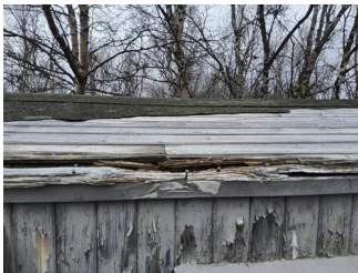
Yttertak og takkonstruksjon - Råteskader og skadet/manglende takteking
