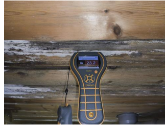
Overflater gulv - Fuktmåling i kjellerbod under bad
