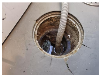
Vanntett sjikt / membran i gulv og vegger - Sluk i vaskerom.
