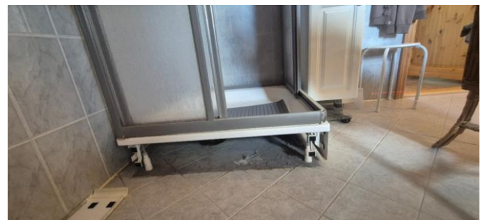
Sluk under dusjkabinett
