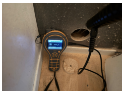
Fuktundersøkelse i vegg inn mot baderom
