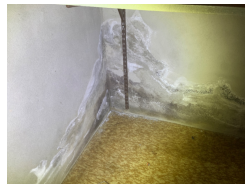
Saltutslag på vegger i kjellerbod
