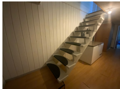
Mangler rekkverk på kjellertrapp
