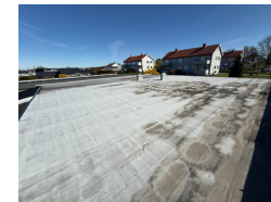
Tydelig søkk i undertak
