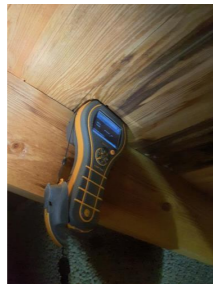
Synlige overflater (taktro, vegger, gulv, o.l) - Fuktmåling med piggelektrode på fuktmerke i taktro ved pipe.
