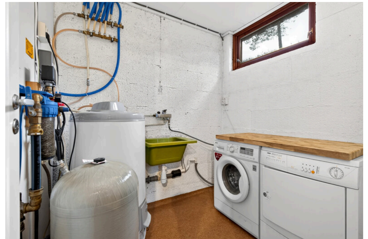
Vaskerom med opplegg for vaskemaskin, varmtvannsbereider og utslagsvask.
