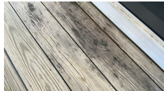
Værslitt og oppsprukket terrassebord med svertesopp
