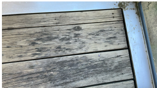
Værslitt og oppsprukket terrassebord med svertesopp
