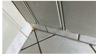
Swelling i bunn av panelplater bak dusjkabinett
