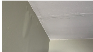
Tapetblære og ujevn takoverflate
