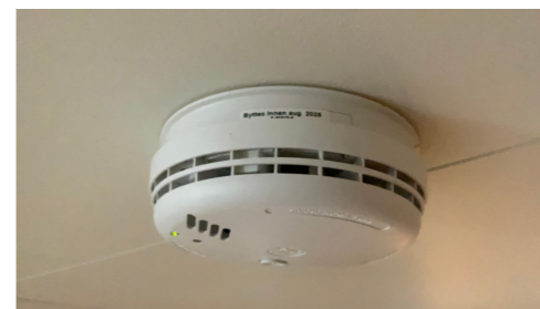
Byttes innen august 2025. Brannvarsler fra x, og er > 10 år, MÅ skiftes.
