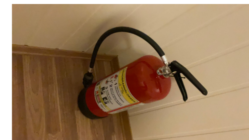
Brannsløkker fra 2014 og er > 10 år, MÅ skiftes.
