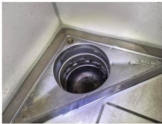
Tettesjiktets tilslutning til sluk - Sluk
