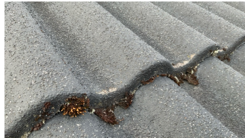
Stedvis mose, stedvis avslitt overflate
