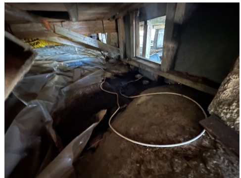
Fritt vann over plast og råte i støtter.
