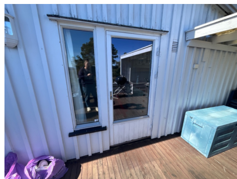
balkong dør med ødelagt håndtak, og sliten utvendig
