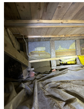
Skadet eternitt plater, åpen isolasjon.
