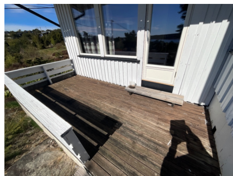
9 kvm cm råde i gulv bord og oppsprukket gulv
