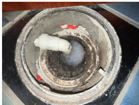
Synlig bane membran under klemring på sluk under vask
