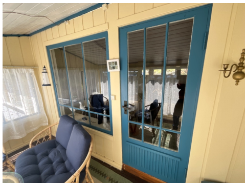
Sprekk i glasset vanskelig å lukke
