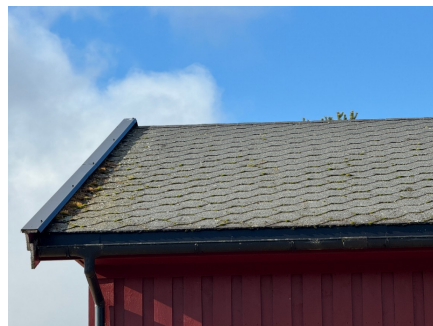
Mose på taktekkingen
