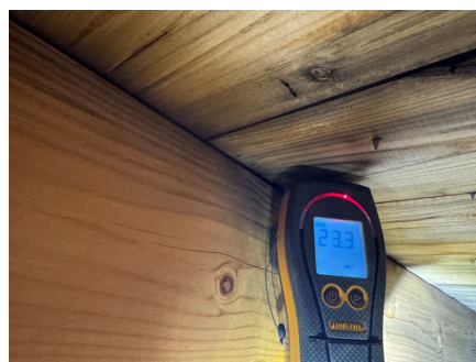
Forhøyede fuktverdier som indikerer at det er noe lekkasje/kondensering rundt gjennomføring.
