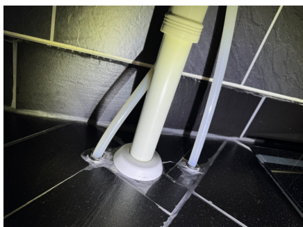
Bilde av rørgjennomføringer i gulv. Ingen tegn til mansjetter rundt rør
