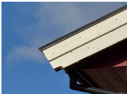
Råteskade i dekkbord
