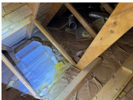
Durgoventil montert på loft
