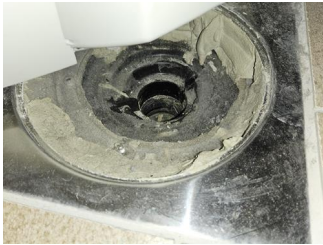
Avløp (inkl. sluk) - Sluk bad vaskerom.
