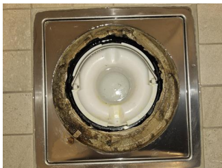
Avløp (inkl. sluk) - Sluk bad 2.etg.
