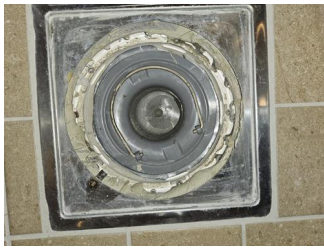
Avløp (inkl. sluk) - Sluk bad U.etg.
