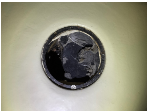
Sluk på toalettrom
