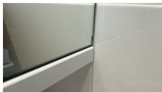
Liten sprekk/skade ved festet
