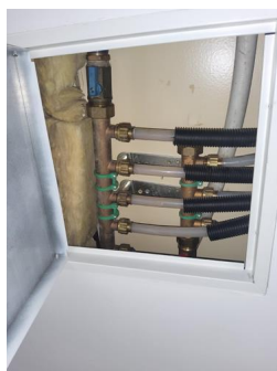
Fordelerskap og fordelerstammer - Fordelerstammer
