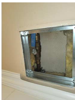
Innvendig stoppekran - Hovedstoppekran
