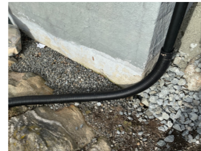
Ingen synlig drenering bakside.
