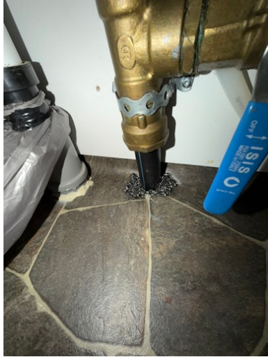
Rørgjennomføringer i gulv.
