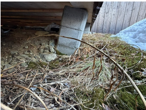
Skjevheter i pilar.
