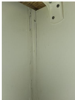
Overflater vegger - Sprekk ved hjørneløsning i dusjnisje
