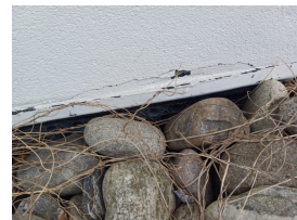
Bilde viser synlig knottelast med klemlist
