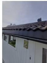
Bilde av manglende snøfangere
