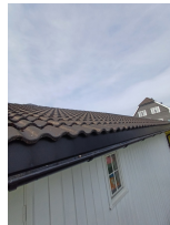
Bilde av manglende snøfangere
