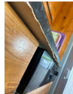
Benkeplate smuldre opp i underkant.
