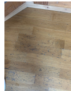
Parkett gulv, slitt overflate på kjøkken
