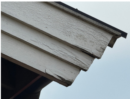
Lokal råte i dekkbord
