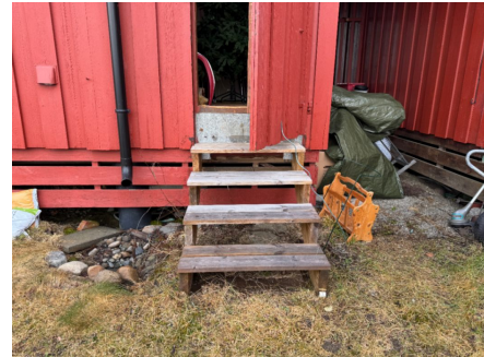
Trapp uten rekkverk
