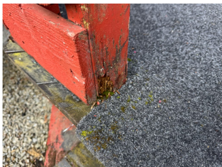
Råteskade i terrasse
