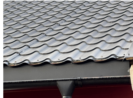
Rust i nedkant på plater
