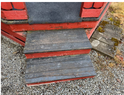
Slitte overflater i trapp
