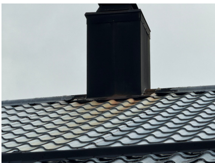
Slitasje på beslag rundt pipe
