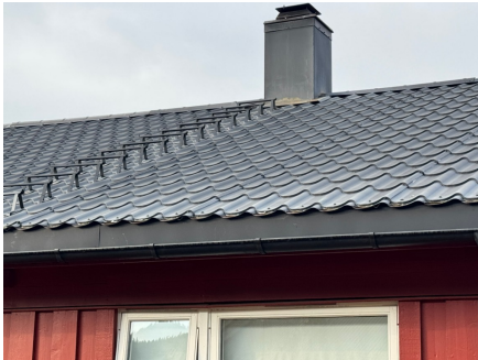
Slitasje på beslag og ikke montert snøfanger
