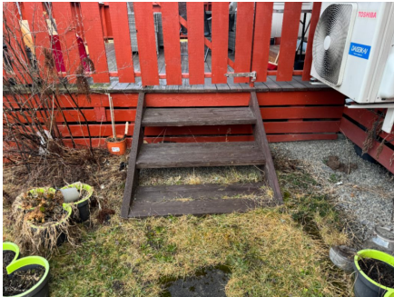
Trapp uten rekkverk
