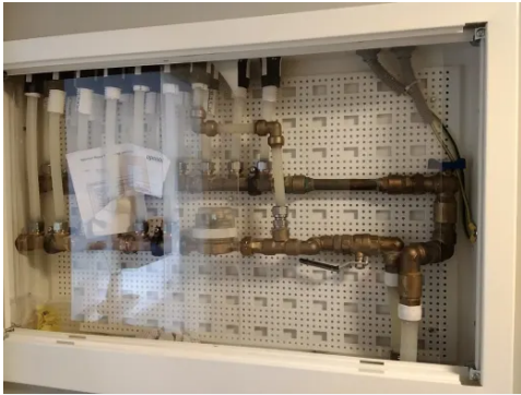
Skap for rør i rør system og hovedstoppekran.
