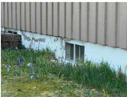
Slitasje på grunnmur
