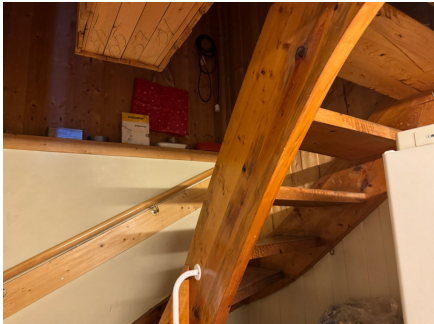
Rekkverk ikke montert i trapp til kjeller
