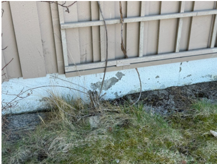
Avflassing på overflater av grunnmur
