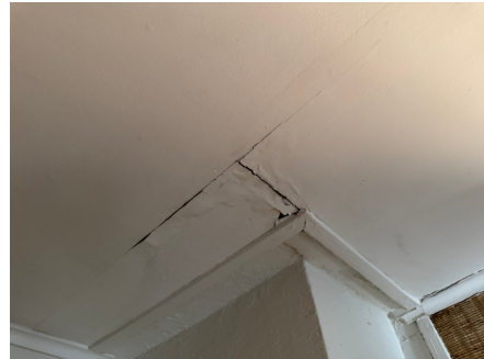
Fuktmerker rundt pipe i himling
