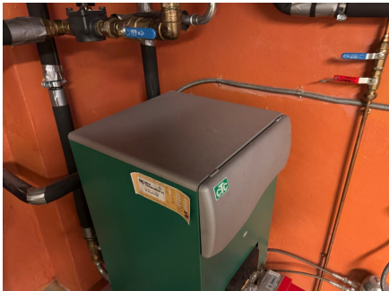
Oljefyringsanlegg i kjeller
