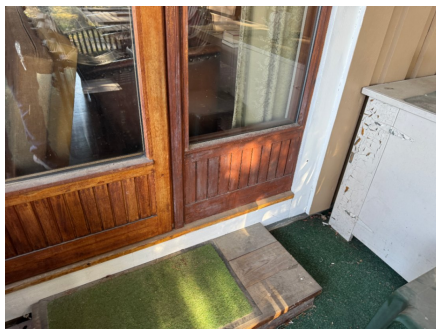
Overlater som er noe slitte på terrassedør
