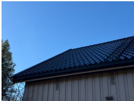
Ikke montert snøfangere på tak
