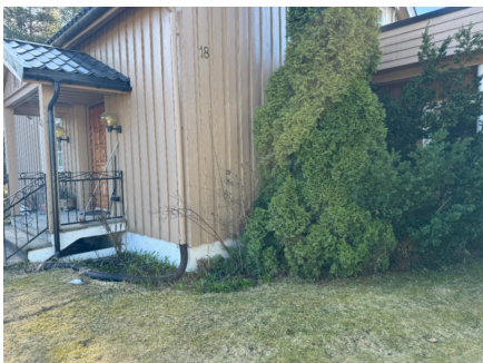
Dårlig fall rundt grunnmur
