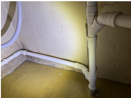
Fuktskjolder i nedre del av grunnmur
