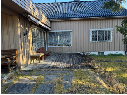
Slitte overflater på platting
