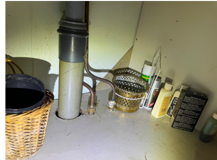
Irr på rørkoblinger i servantskap på tilbygget del
