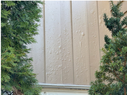
Blæring på maling av panel
