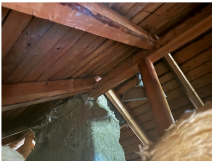
Lokale fuktmerker rundt pipe i undertak på loft etter tidligere lekkasje
