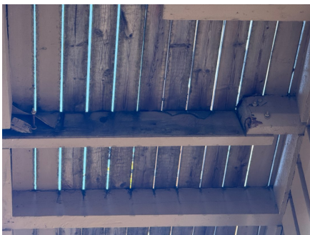
Bjelke under gulv på veranda som er skjært bort
