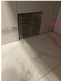
Inspeksjonsluke til sluk under badekar
