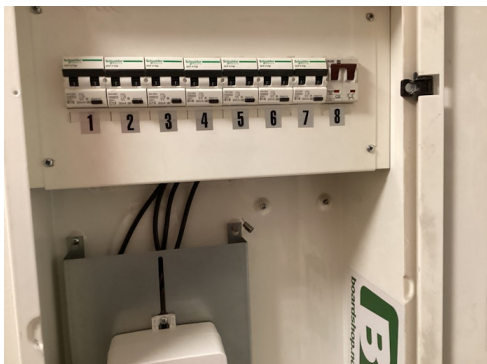
Bilde av sikringskap.
