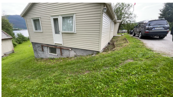
Fall på terreng mot bolig
