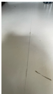
Skade i skjøt på gulvbelegg på soverom i 2. etasje
