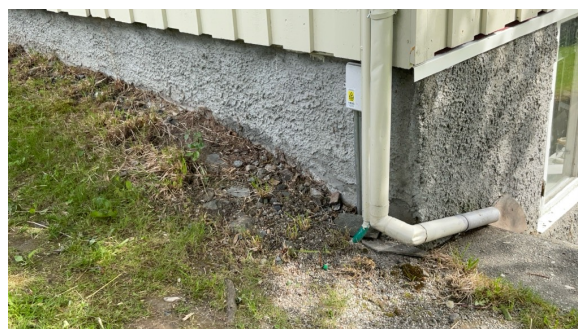
Hovedstrømkabel utvendig er ikke tilstrekkelig sikret med vern. Fare for skade ved f. eks kantklipping eller annen belastning
