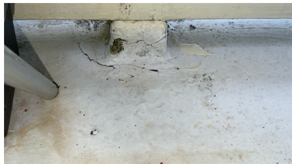
Sprekker i dekke ved overgang mot rekkeverk
