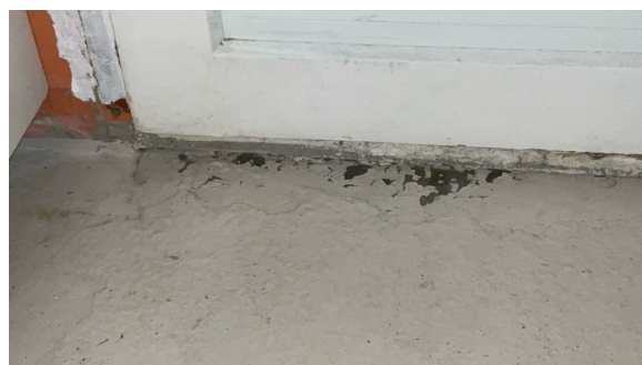
Avskalling av overflate på gulv
