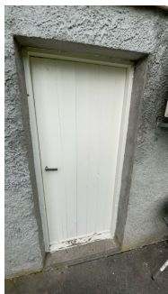
Dør inn til stue i underetasjen. Tar i karm
