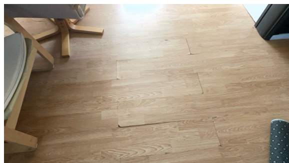
Gulv i stue er skadet i 2. etasjen
