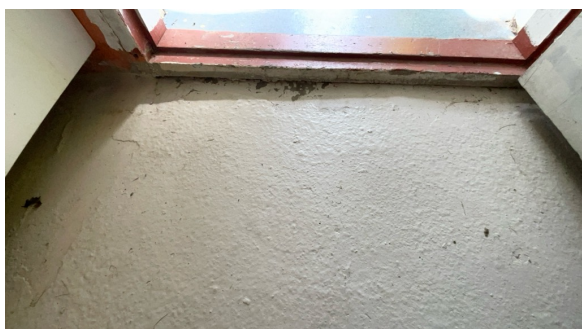
Fuktopptrekk i gulv som medfører at maling slipper
