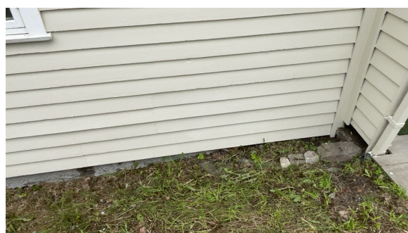
Skiftet deler av kledning og deler av bunnsvillifølge eier på øvre vegg. Kort avstand til terreng.
