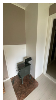
Vedovn på stue 2. Sprekk i bakplate
