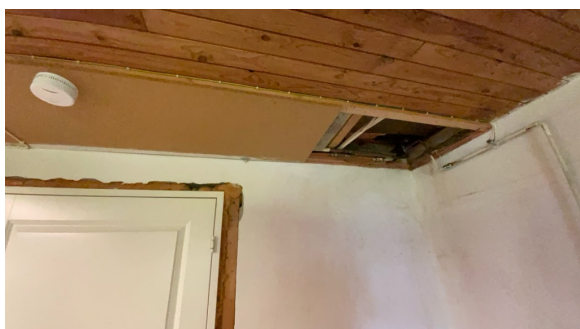
Åpent i himling etter tidligere skade på rør
