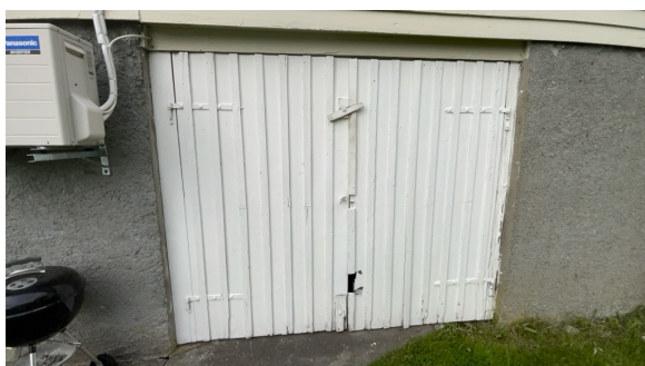
Plassbygget garasjeport. Noen løse bord og råde/værslitasje på nedre del og sidebord
