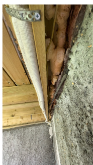
Overgang ved veranda på forsiden er det synlig byggeskum bak kledning
