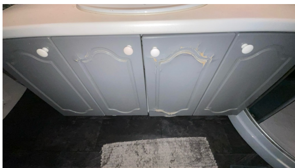
Svelleskade på innredningen
