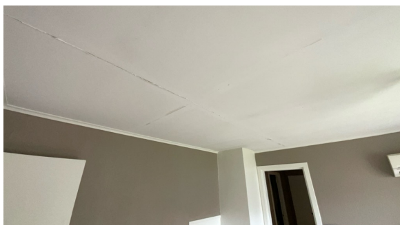
Sprekk/skader i plateskjøter himling i stue 2 i 1. etasje
