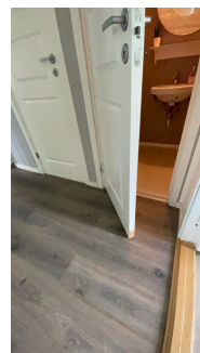
Skade på folie til dørblad mot toalettrom og det er overflateskade
