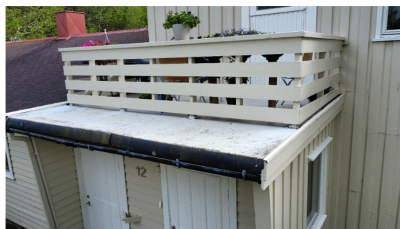
Oversikt. Synlig nedbøyning i takrenne
