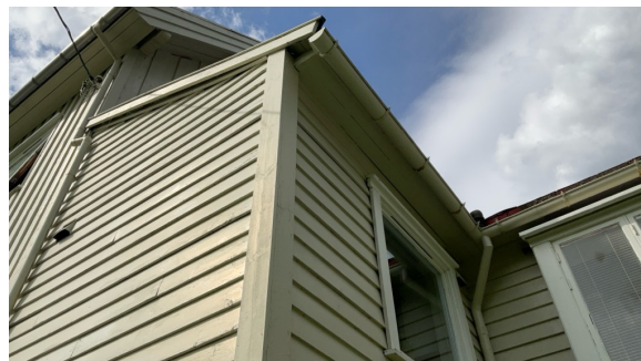
Ingen synlig luftespalte på tilbygg over kjøkken
