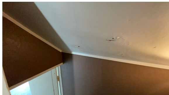
Skader i himling i trapperom loft
