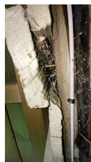
Begrenset luting grunnnet lufting kun på overbord. Mangler musetetting
