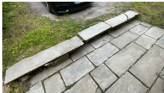
Skifertrinn ved inngang er løse
