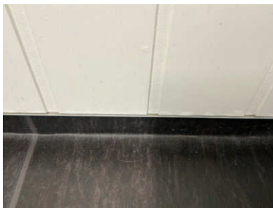
Fuktskader i veggplater.
