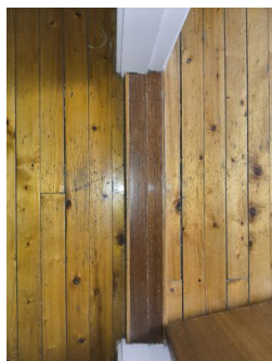
Overflate gulv - Glipper og skder i gulv
