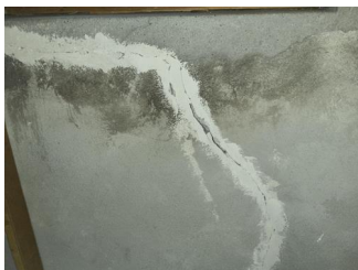
Overflate vegg - Sprekker i mur
