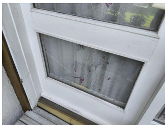
Ytterdører og omramming - Knust glass
