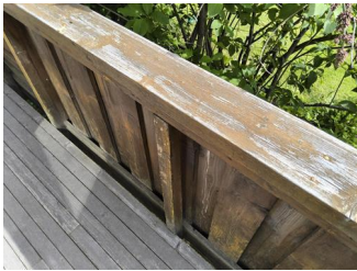
Tilstand på rekkverk og overflatematerialer - Slitt overflatebehandling
