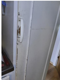
Innredning - Skader på innredningen
