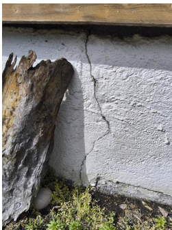
Grunnmur og fundament - Sprekk i grunnmur
