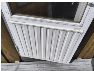
Ytterdører og omramming - Slitt balkongdør
