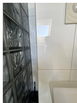
Manglede fugemasse tolettkasse
