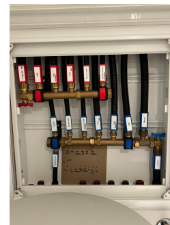
Rørskap i bad/vaskerom (sokkeletasje).
