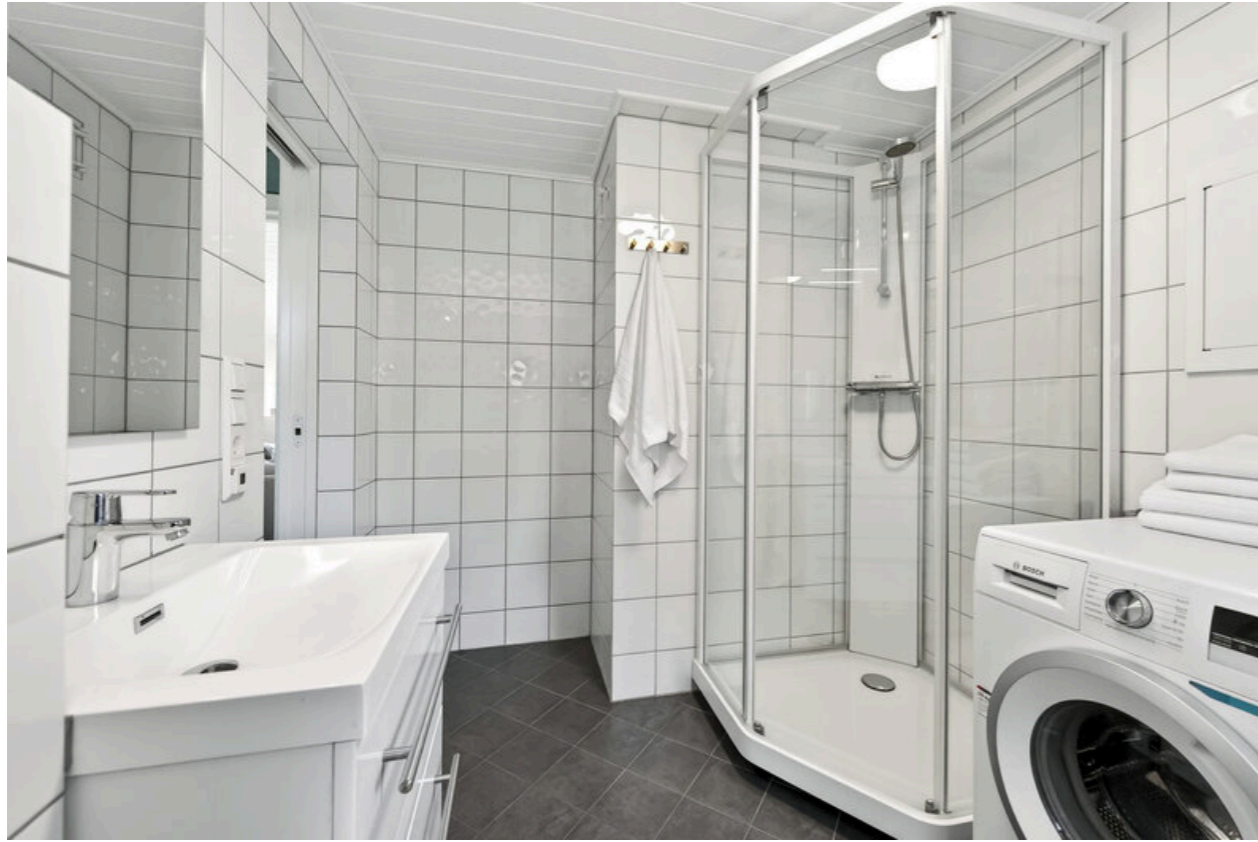
Varmekabler i gulv.
