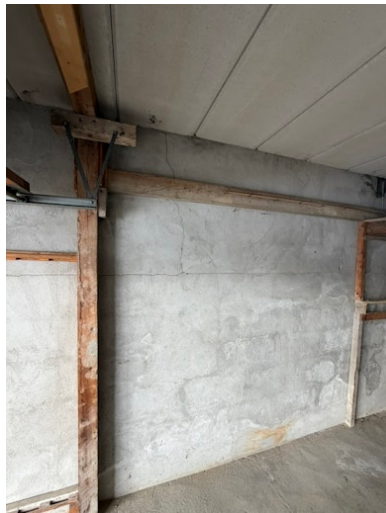
Sprekk i grunnmur i garasje
