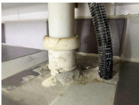
Det registreres ikke noe rørmansjett på rørgjennomføringer i gulv.
