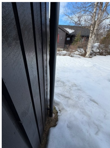
Isspreng i nedløpsrør.
