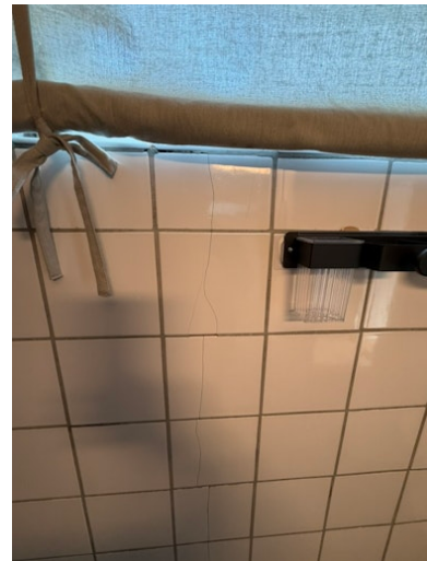
Sprekk i flis på bad i underetasje.
