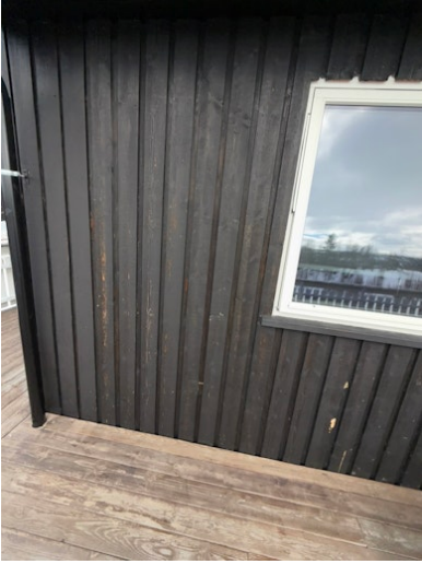
MÅnglende vedlikehold av utvendig kledning
