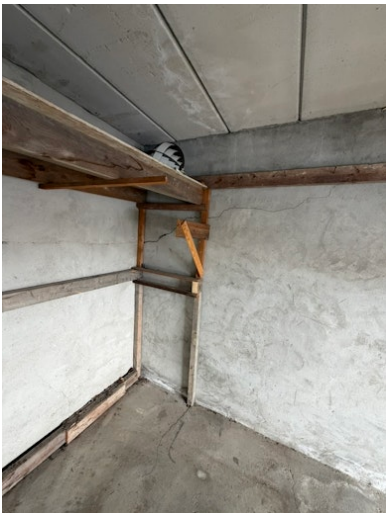
Sprekk i grunnmur i garasje
