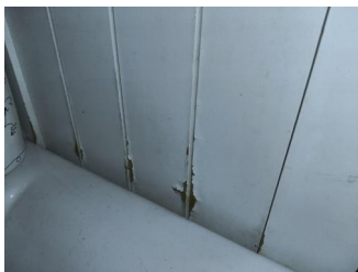
Sanitærutstyr og innredning - Svelleskader på høyskap
