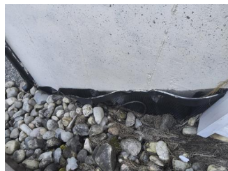
Fuktsikring av grunnmur - Skader i utvendig fuktsperre
