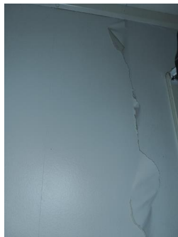
Overflate vegg - Skader og riss i vegg
