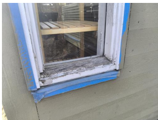
Vinduer, dører og porter - Skadet vindu
