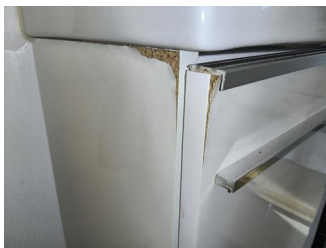
Sanitærutstyr og innredning - Skader i servant innredning
