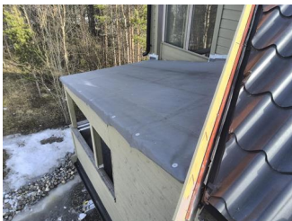
Tekking (med tilhørende beslag) - Uferdig tak over balkong
