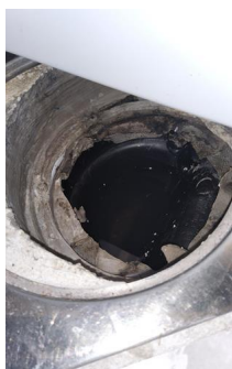
Avløp (inkl. sluk) - Sluk ved vaskemaskin
