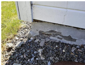
Grunnmur og fundament - eksponert armering
