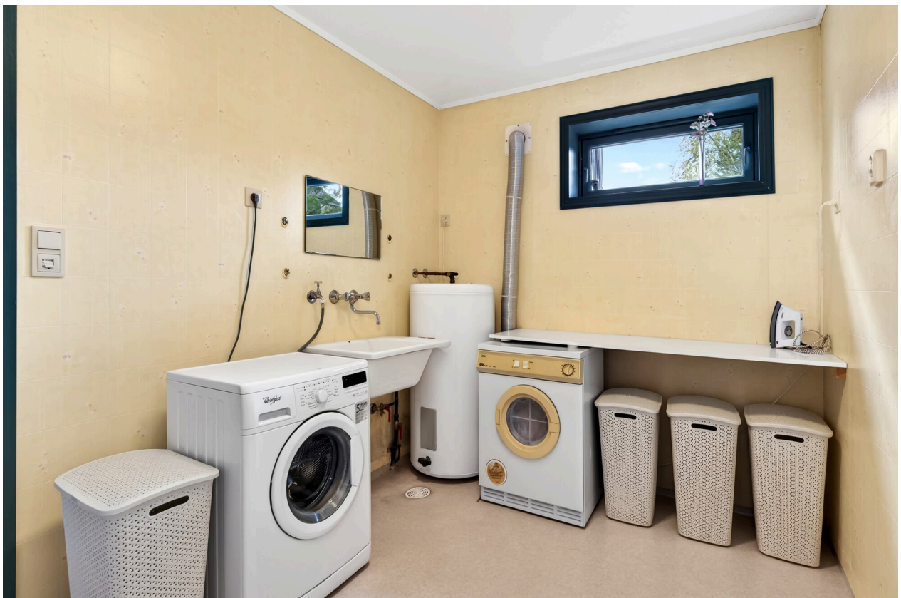
Vaskerom med utslagsvask, varmtvannsbereder og opplegg for vaskemaskin.
