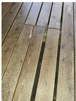
Tilstand på rekkverk og overflatematerialer - Glipper og skader i terrassebord
