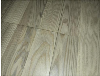
Innerdører - Merker etter kontakt med gulv
