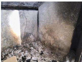
Ildsteder - Sprekker i peisovn
