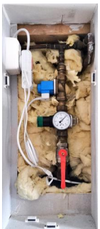
Innvendig stoppekran - Stoppekran med lekkasjevakt
