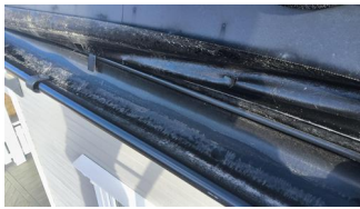
Takrenner og utvendige nedløp - Beslag med for lite overdekning
