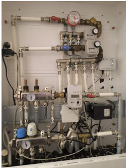
Fordelerskap og fordelerstammer - Fordelerskap
