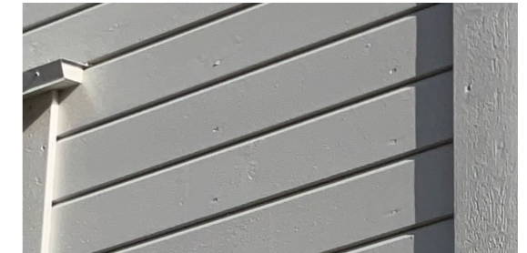
Spikerhodet noen steder ikke flukter med bordkledningens overflate
