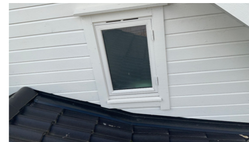
Det mangler beslag på vannbrett over vindu. på noen av vinduene.
