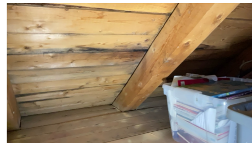
Fuktskjolder/skader i takkonstruksjonen.
