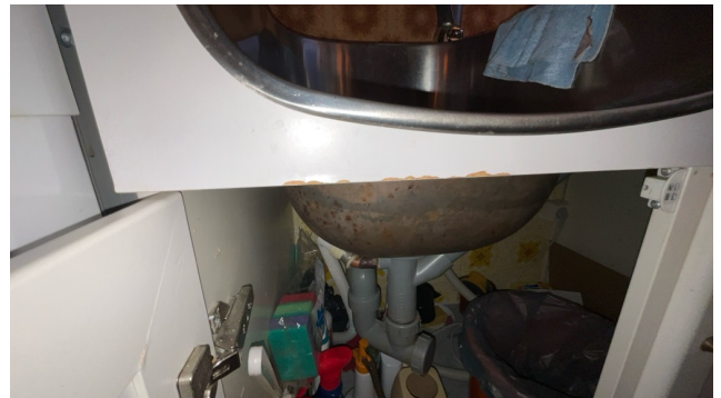
Fuktskader i kjøkkenfront
