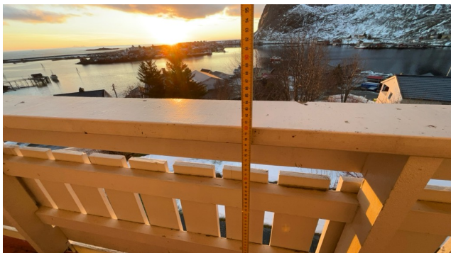
Rekkverk på balkong er 80cm, 20 cm mindre en dagens krav
