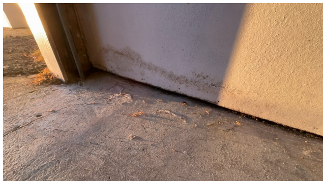
Fuktskader i veggplater i garasje
