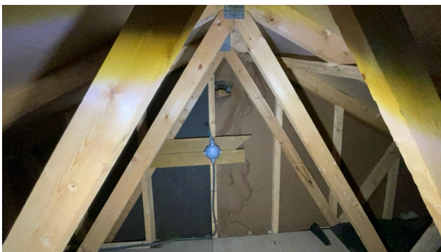
Fuktskjolder i røstvegg
