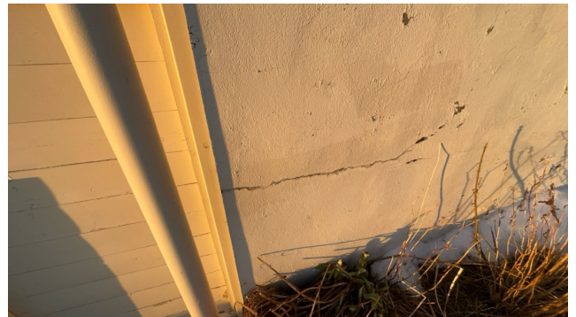
Sprekk i grunnmur
