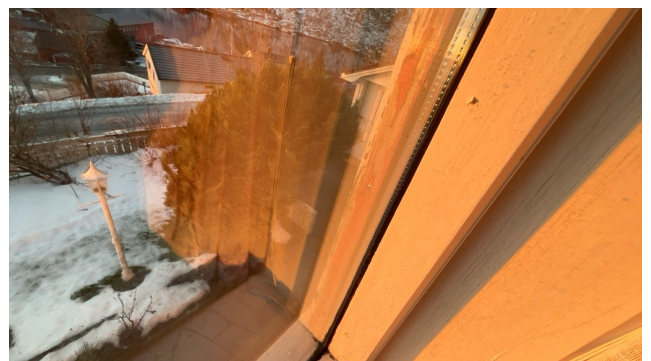
sprekker og slitasje i utvendige glasslister
