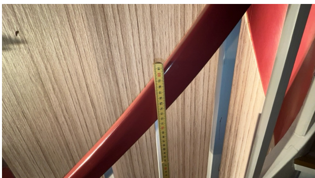
Rekkverk i innvendig trapp er 80cm, 10 cm mindre en dagens krav
