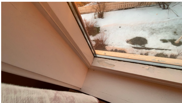
Slitasje i vinduskarm
