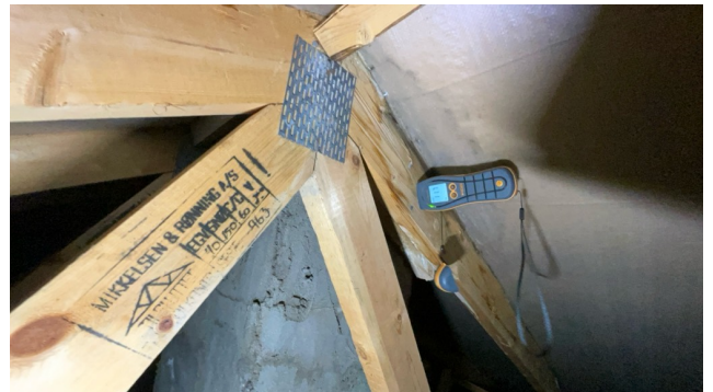
Fuktmåling i fuktskjolder uten høye fuktverdier.
