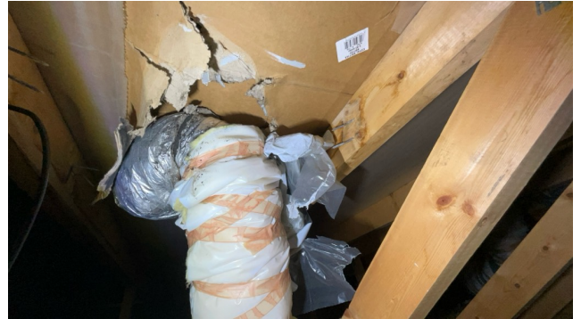
Skader i undertak som kan være utett
